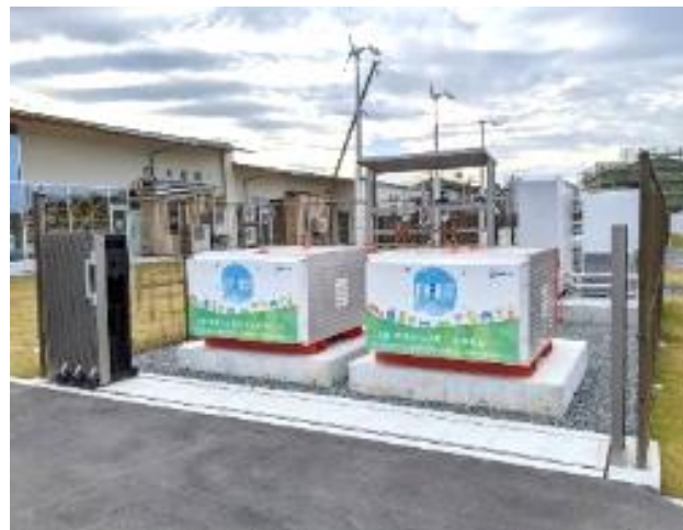
水素燃料電池（道の駅）
